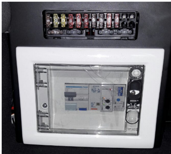
Figura 14 – Fusibiliera dei carichi principali e quadro elettrico impianto.
