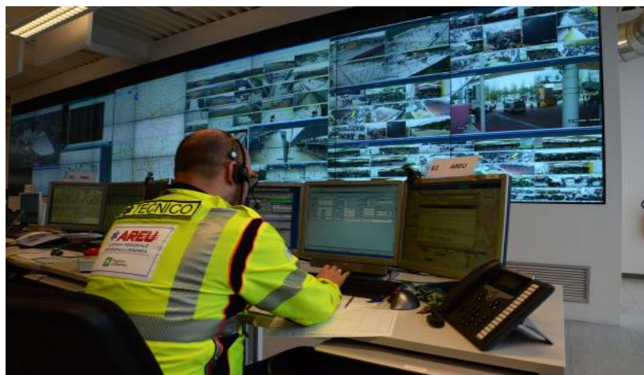
Figura 33 Postazione Sanitaria in Sala EC3 (Sottocentrale di SOREU)
